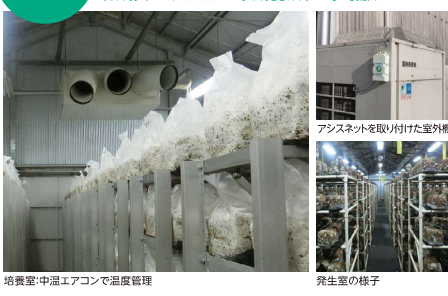
培養室・中温エアコンで温度管理 発生室の様子
